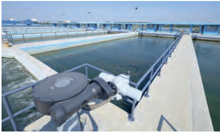
Tratarea apei – filtru de nisip
