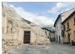
Fig. 9. Clădiri după cutremur
